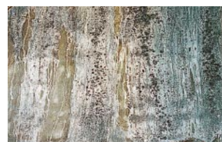
カビ発生現場
